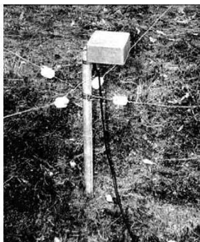
Fig. 3 • Il punto di connessione centrale alla base di un sistema a due loop installato da Gary Breed, K9AY
